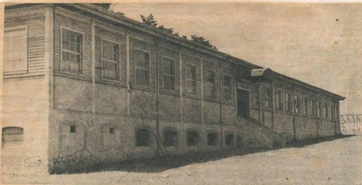
LA MADERA PODRIDA Y APOLILLADA puede verse en uno de los costados del Museo Nacional de Historia y Bellas Artes. En la parte inferior, las ventanas del sótano que alberga una húmeda bodega que es practicamente inutil y que solo guarda objetos que esperan ser desglosados del inventario.
